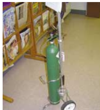
図4 山頂の制御室に設置してある緊急用酸素ボンベ
